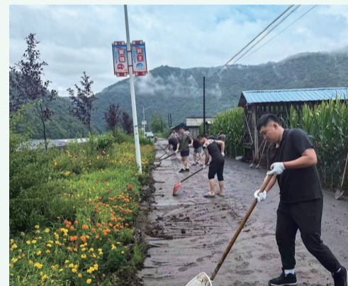
抚松县组织各乡镇、部门对域内房屋、道路进行排查。
