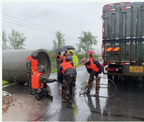
蛟河市交通运输局组织抢修省道蛟凤线涵洞，筑牢交通保障防线。
